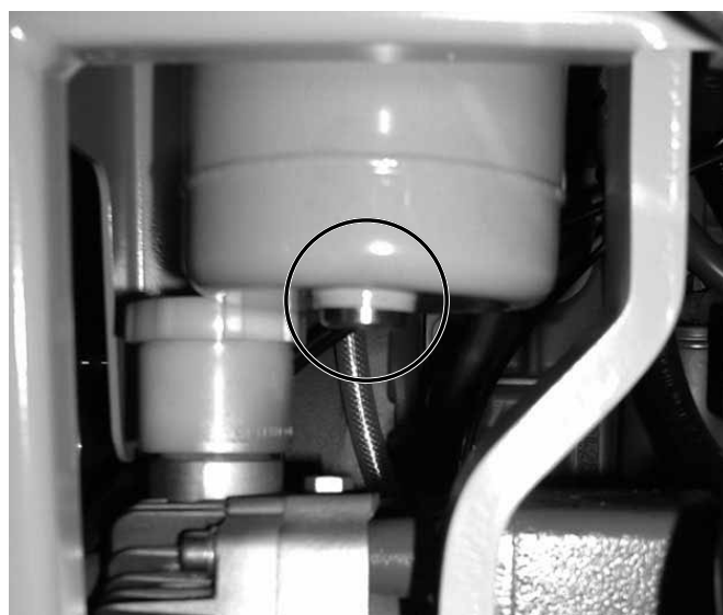
Сливной винт масла под электрогидравлической компактной маслостанцией,
