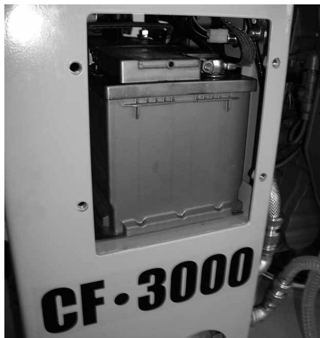
CF-3002 D справа, крышка аккумулятора снята
